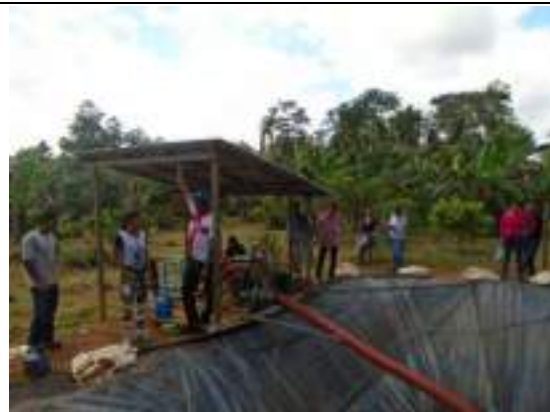
Foto 76: O sistema de irrigação foi implantado em fevereiro de 2019, como parte dos Programas Ambientais da UHE Belo Monte (roça de Giliard, aldeia Miratu, campanha de inverno, 06/5/19).
