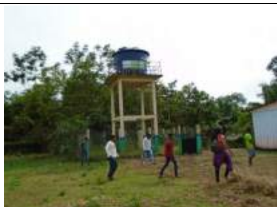
Foto 11: Caixa d'água – aldeia Paquiçamba (02/05/19).
