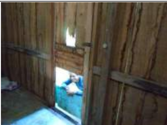
Foto 35: Estado de degradação da Casa de Artesanato da aldeia Paquiçamba, construída como parte dos Programas Ambientais da UHE Belo Monte (03/5/19).
