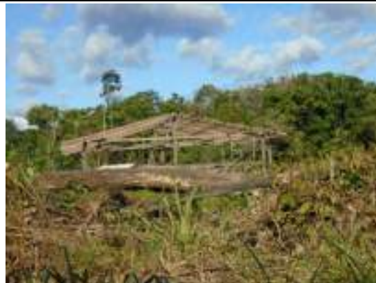
Foto 14: Estrutura de casa sendo construída na Aldeia Lakariká durante campanha de inverno (26/4/19).
