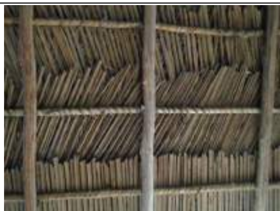
Foto 41: Detalhe da cobertura de palha de inajá ( Attalea maripa ) existente na Casa da Cultura do Índio da aldeia Furo Seco (25/4/19).
